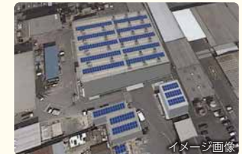
イメージ画像 アースサポート(株)本社の屋上へ太陽光発電設備を設置
